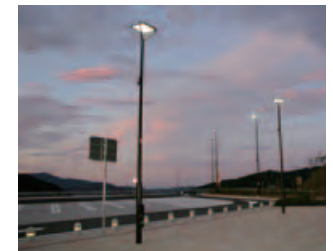
加斗パーキングエリアのLED照明調光システム
